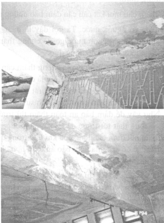
Hình 5.13. Sàn BTCT bị thẩm do nứt
